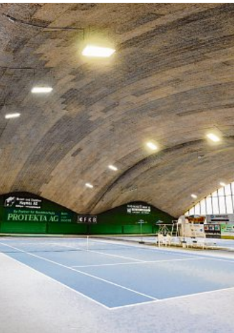
Die LED-Lampen erleuchten die Tennishalle.
